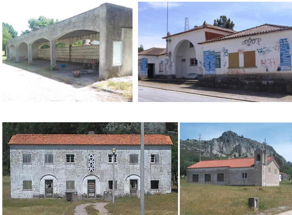
Fig. 10. Exemplos de edifícios em mau estado de conservação.
