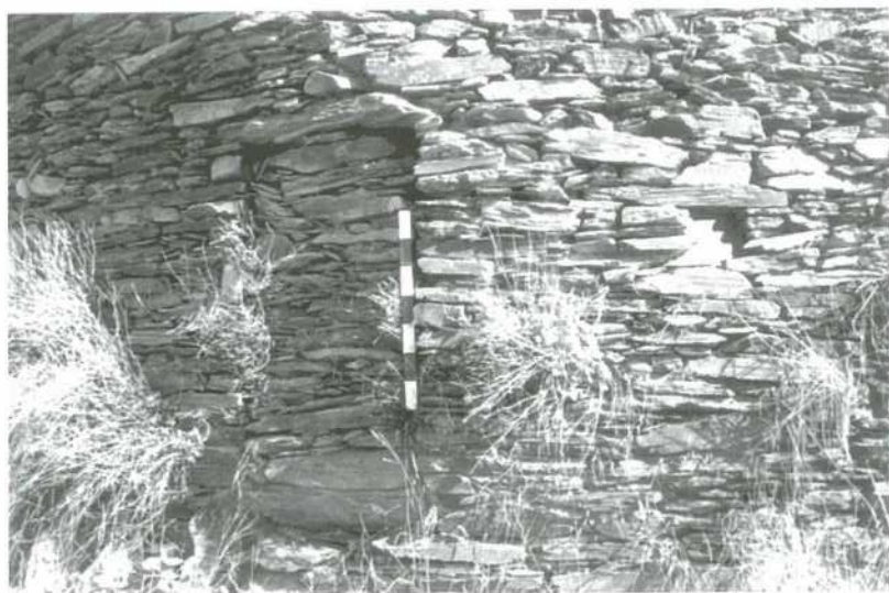
Fig. 8. Muro do Vale do Gamo. Uma porta condenada, assinalada pela escala, e aspecto de um dos diversos orifícios existentes no muro.
