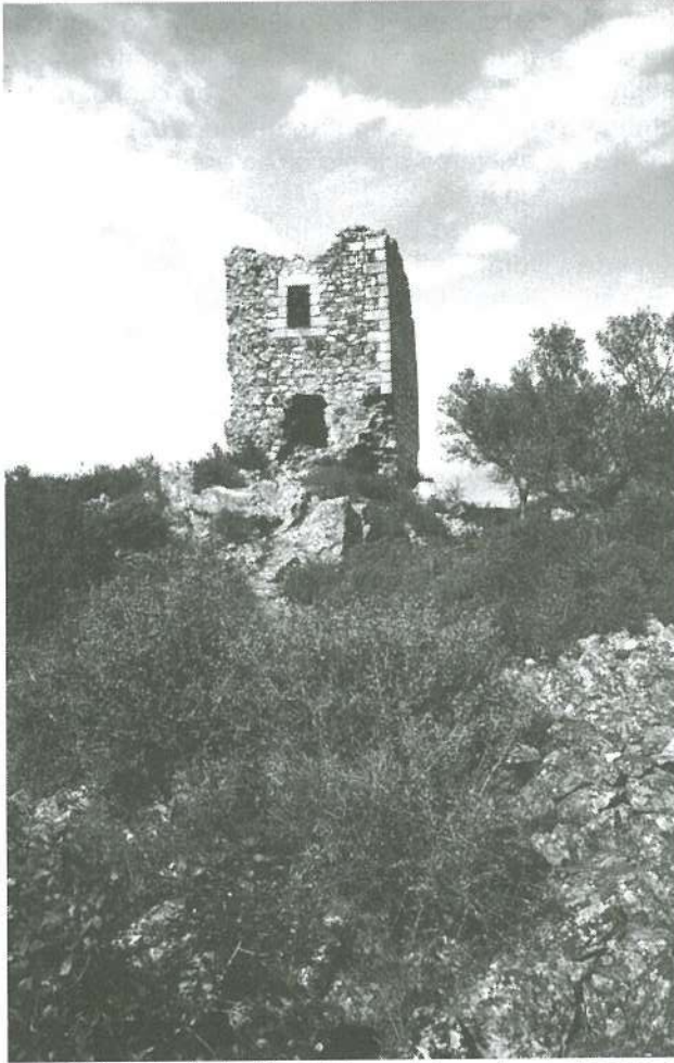
4. Vista da fachada sul do castelo onde se observa a porta (em cima), o buraco aberto na parede da torre e o estado de degradação dos cunhais, especialmente o que está virado a sudoeste.
