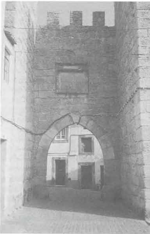
O arco, os brasões e os atentados ao património (Foto de J. Murta)
