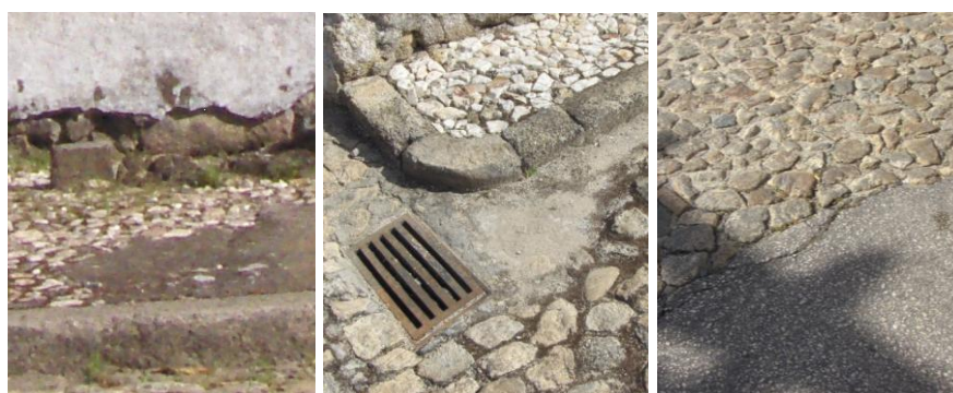
Fig. 17. Exemplos de pavimentos degradados e transição de materiais mal resolvida.
