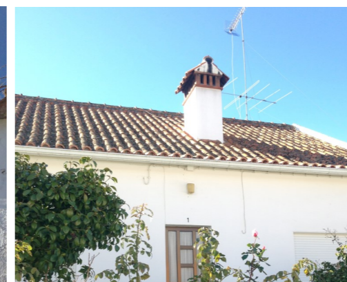
54 | Cobertura com manchas
