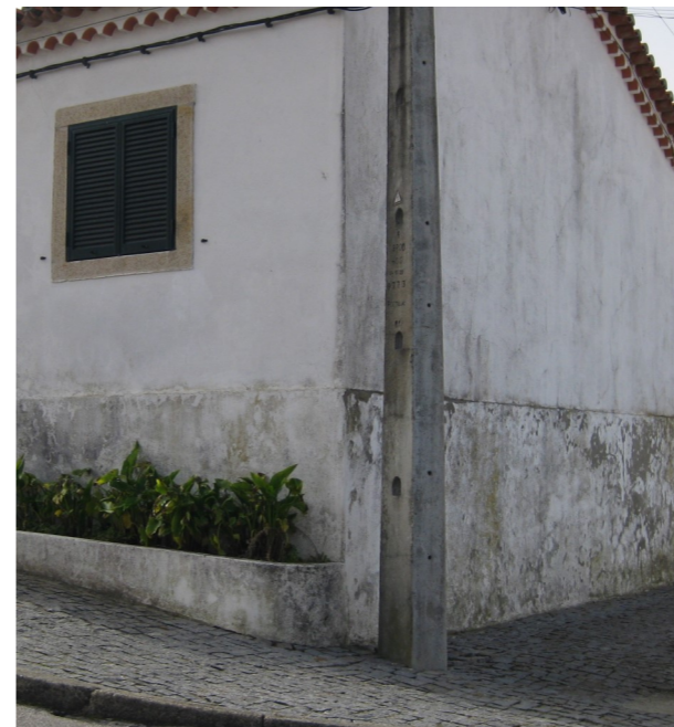
61 | Presença de manchas e bolores na fachada
