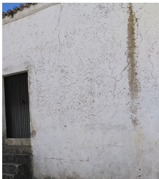
59 | Fachada com fissuras
