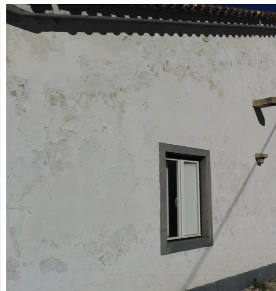
60 | Desagregação de reboco
